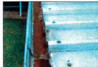
Écoulement d'eau d'une toiture en acier Galvalume non peint, sur une gouttière en acier galvanisé.
