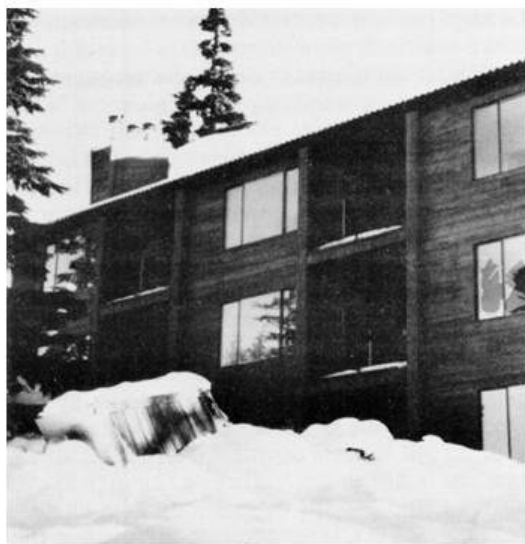
Figure 2. Au premier plan, sur le sol, cheminée arrachée d'un toit métallique en pente sous l'action d'une forte surcharge de neige. Remarquez la neige retenue par ce qui reste de la cheminée. Mt. Washington(C.-B.) (photo - D. Cronmiller, Comox, C.-B.)
